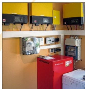
Batteriespeicher und Wechselrichter zu einer Photovoltaik-Anlage, die das Sonnen-Energie-Zentrum gebaut hat. BILD: SEZ
